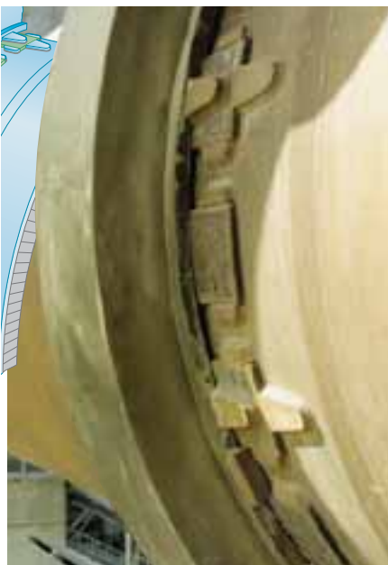
Loose Laufring- befestigung.
