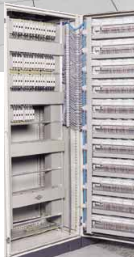
...im Schaltschrank integrierten Modulen.
