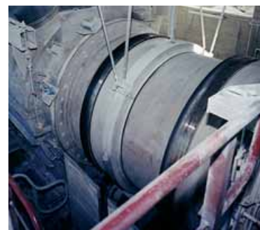
Twin-Kühlerkonzept in einer spanischen Weißzementanlage.
