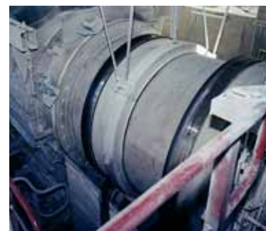
Concepto de enfriadores en cascada en una planta de cemento blanco en España.
