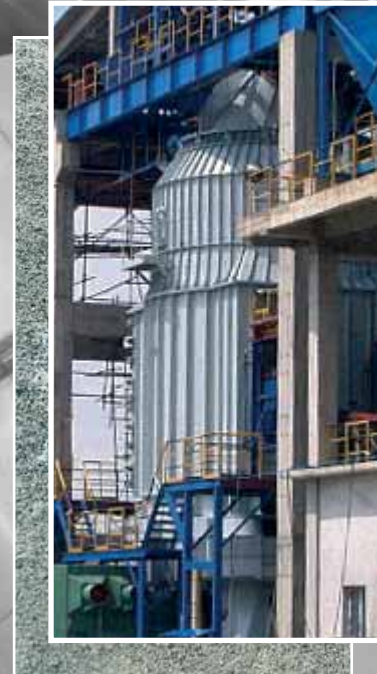
Rollenmühle zur Hüttensandmahlung in China.
