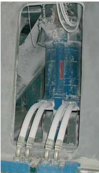
Hydraulikzylinder der Rollenmühle.
