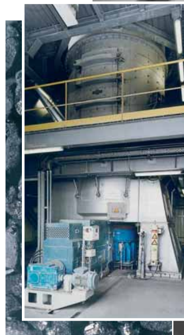
Kohlemahlanlage in Polen.
