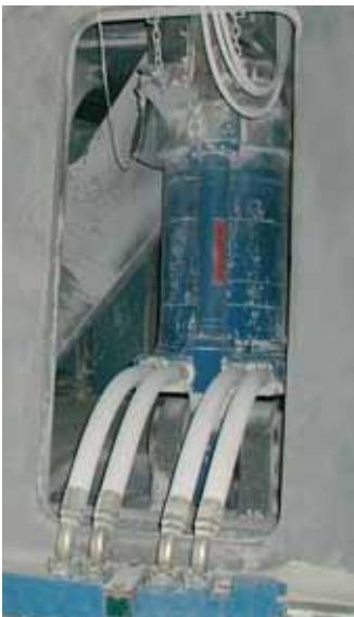
Vérin hydraulique du broyeur à galets.
