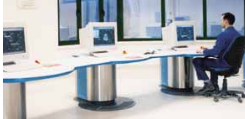
Poste de contrôle moderne avec système de conduite de procédé POLCID® NT.
